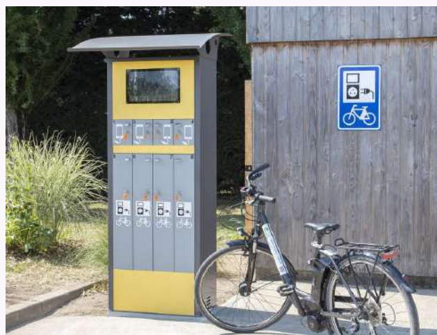
Aménagement recharge borne vélo électrique, Loire à Vélo
